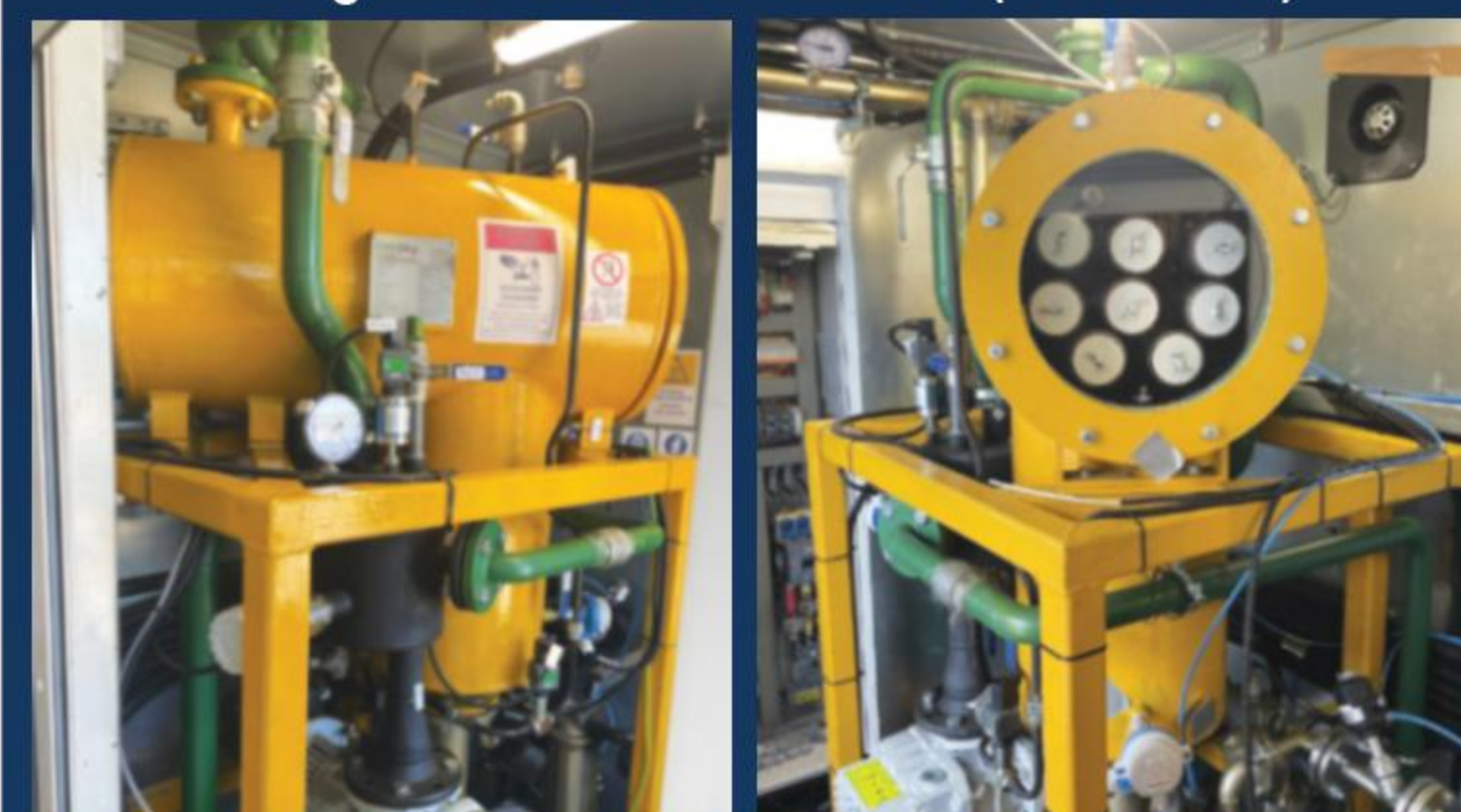
Vakuunkammer zur Entfernung von Gas und Wasser
