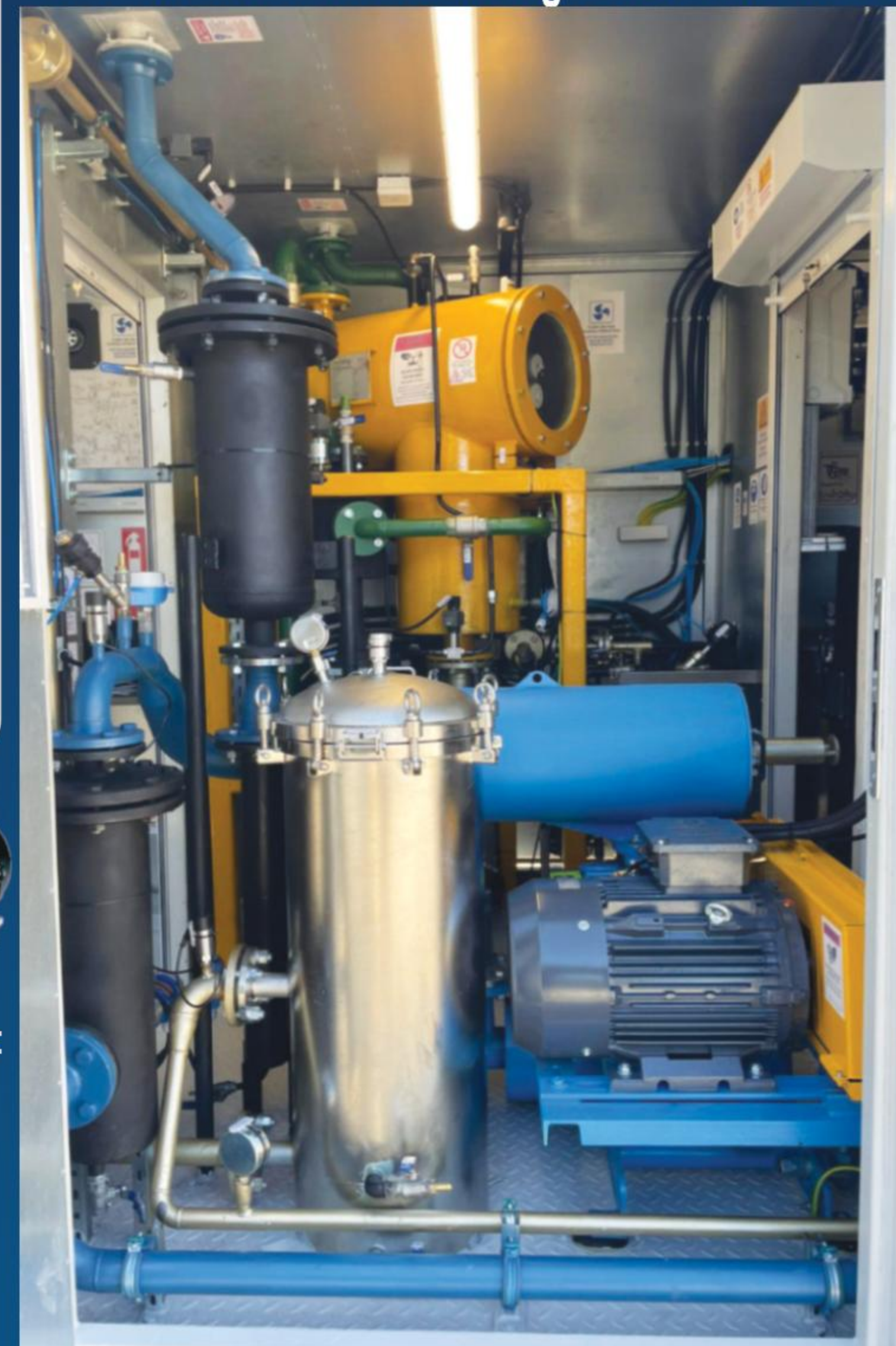
Reinigungsraum (Vakuunkammer, Kartuschenfilter, Roots-Gebläse, Demister, Aktivkohlefilter, Förder- & Austragspumpen, ...)
